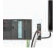
SINAUT RTU İstasyonu
